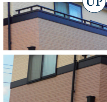
窓枠やベランダの取っ手などの 雨の跡が付きやすい部分が汚れていません。
